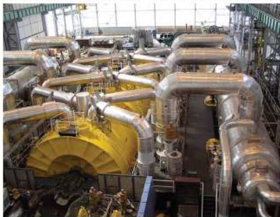
Strojovna TG 1000 MW - v popředí demontovaný vysokotlaký díl
